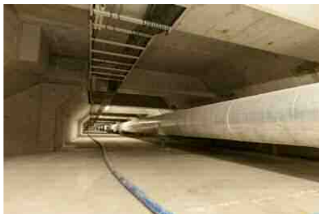
チ・カ・ホ地下ピット内の熱導管
