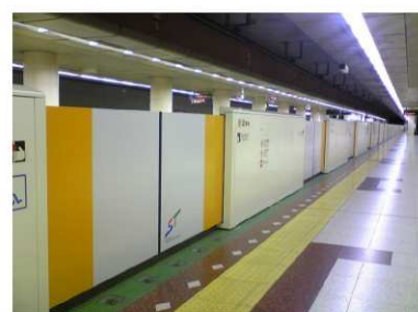
地下鉄ホーム柵
