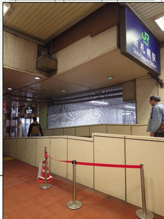
建物間からの雨水浸入
