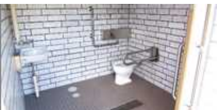
トイレのバリアフリー化の事例
