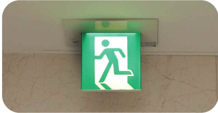
避難口誘導灯(避難口がわかる)
