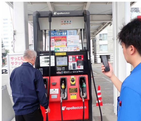
可搬式制御機器と計量機の連動状況
