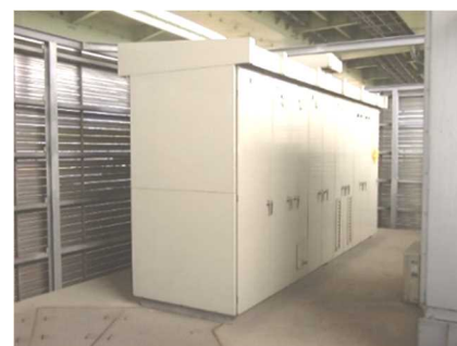
キュービクル式蓄電池設備（例）
