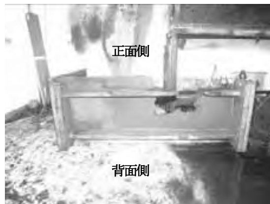
【写真4】 木製棚底板裏側
