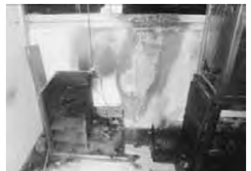
【写真2】 水飲み場壁面等の焼損状況
