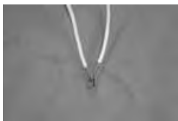
写真 8 緩く結線した状態
