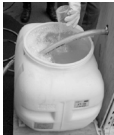
写真2 ポリエチレン製消火水タンク
