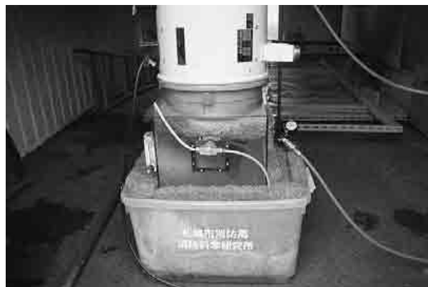
写真 5 実験後の除害装置の状況
