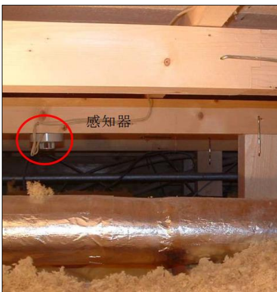
【小屋裏の感知器の設置状況】
