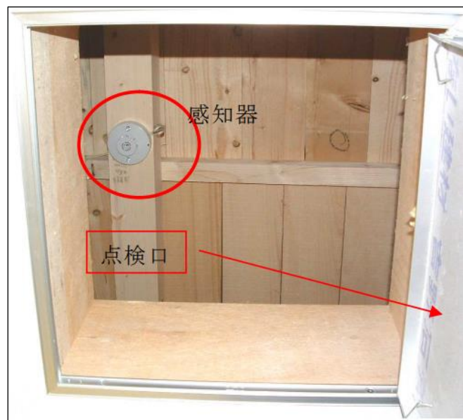
【小屋裏の感知器の設置状況】
