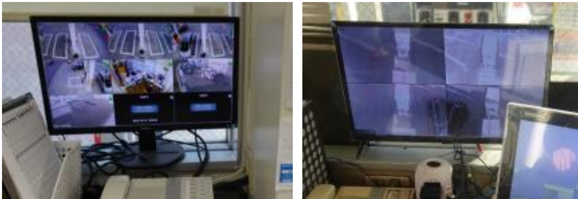
【監視カメラ用モニターの例】
