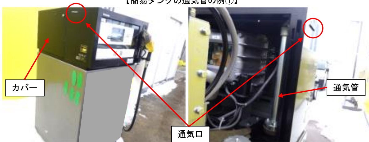
【簡易タンク外観】
