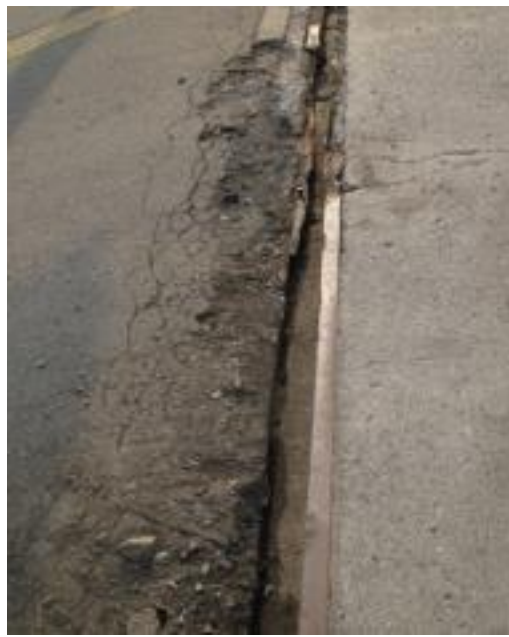
【破損した排水溝の例】
