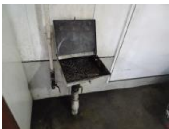
【廃油タンクの注入口（バケツ）】
