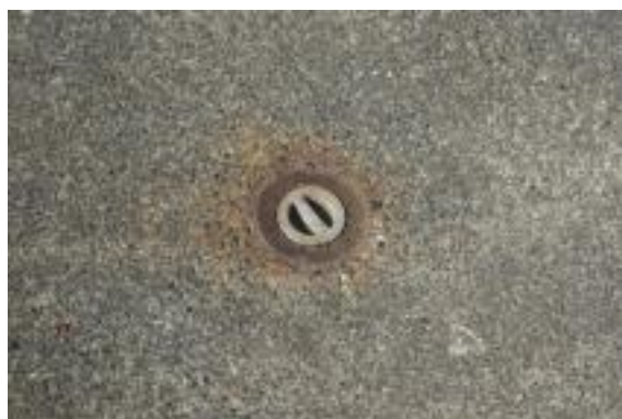
①漏えい検査管のふた
