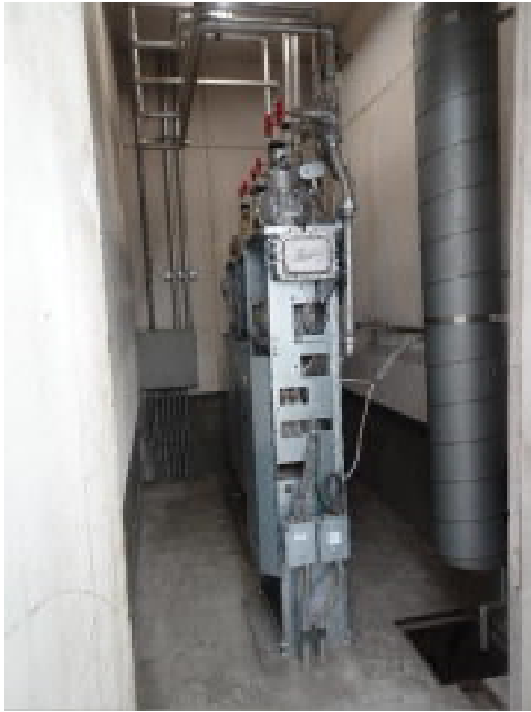
【ポンプ室の例】
