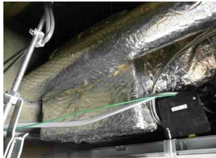
ダクトファン
