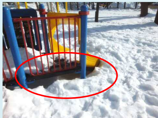
コンビネーション遊具下空洞
