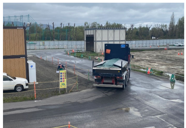
荷台のシート状況
