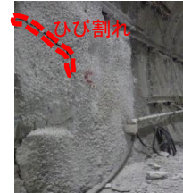
吹付けコンクリートのひび割れ
