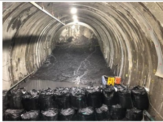
トンネル坑内土砂流入状況
