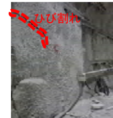
吹付けコンクリートのひび割れ
