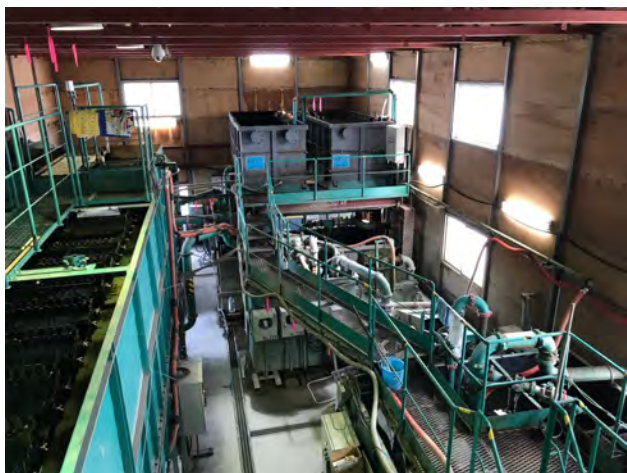
【写真】濁水処理設備（例）内部
