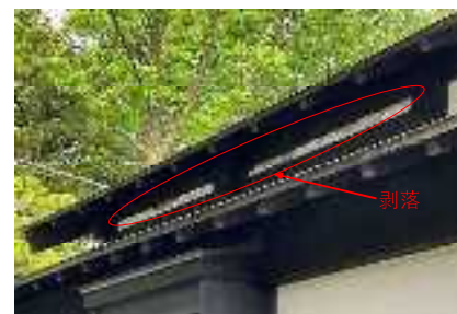
写真7：南側外壁 漆喰劣化部分1
