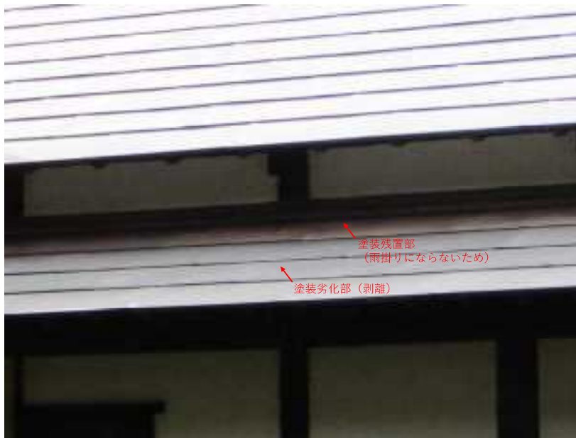
写真 9：南側屋根板金 塗装劣化部
