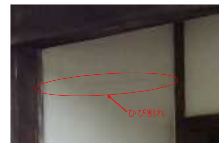
写真8：南側外壁 漆喰劣化部分2
