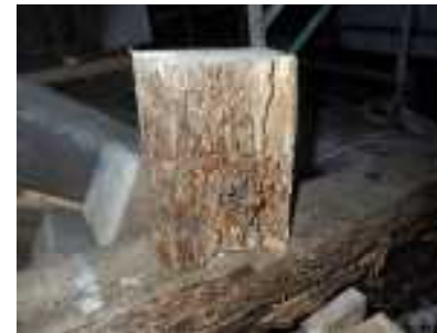
参考写真1：蟻害を被った土台部(清華亭)
