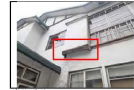
劣化番号2 下枠のはずれ
