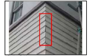
劣化番号3 隅角部 下見板のずれにより 隙間が生じている
