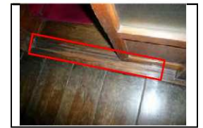
劣化番号6 引違戸 レールの破損
