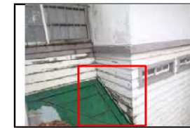
劣化番号5 下見板の腐食、割れ
