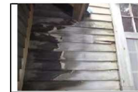
劣化番号11 下見板の腐食
