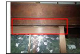
劣化番号8 窓開口 建付け不良
