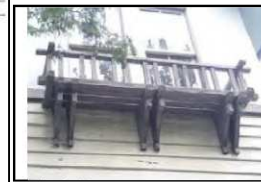
劣化番号4 窓台の腐食
