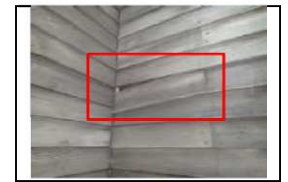
劣化番号9 下見板のずれ
