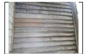
劣化番号12 下見板の風化、割れ
