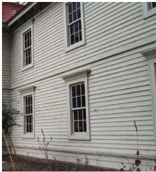
令和4年12月 南側塗装面の荒れが全体的に確認できる
