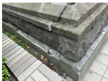
軟石塀の割れ
