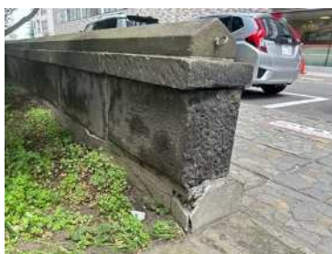
軟石塀基礎部のモルタル剥離
