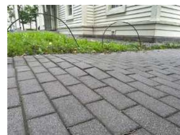
ブロック舗装の不陸
