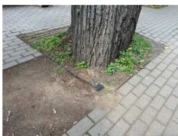
ブロック舗装の不陸や剥がれ
