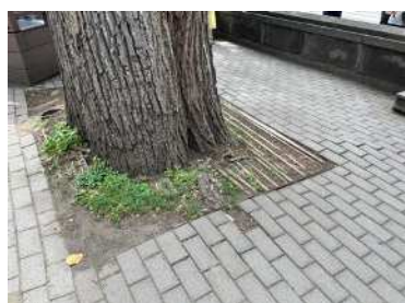
ブロック舗装の不陸や剥がれ
