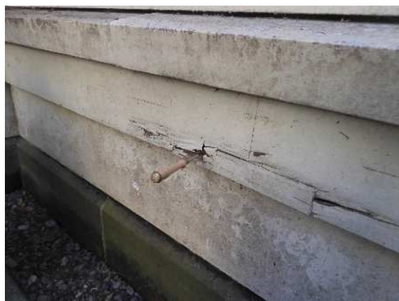
調査写真6. 下見板の腐朽状況
