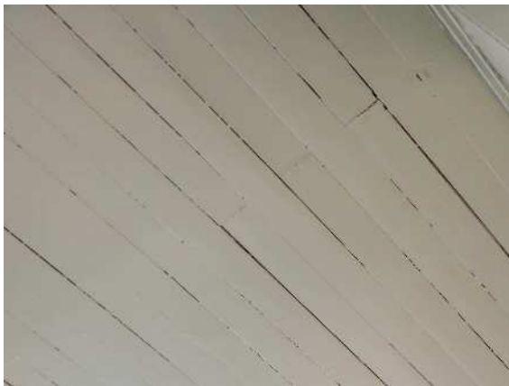
調査写真11. 1階大展示室 天井板の隙間(詳細)
