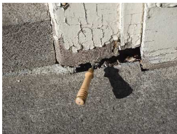
調査写真4. 東階段室 南面出入口付近の柱足元の腐朽
