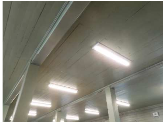
調査写真10. 1階大展示室 天井板の隙間
