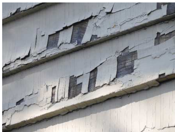
調査写真2. 南面外壁の塗装剥離(詳細)
