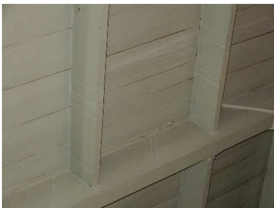
調査写真15. 2階ホール 合掌・母屋・野地板の雨漏り跡
