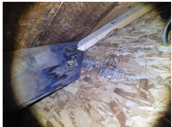
調査写真14. 2階ホール 小屋裏より母屋の雨漏り跡
