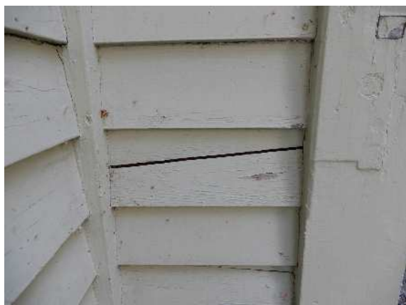
調査写真7. 外壁下見板の割損状況
