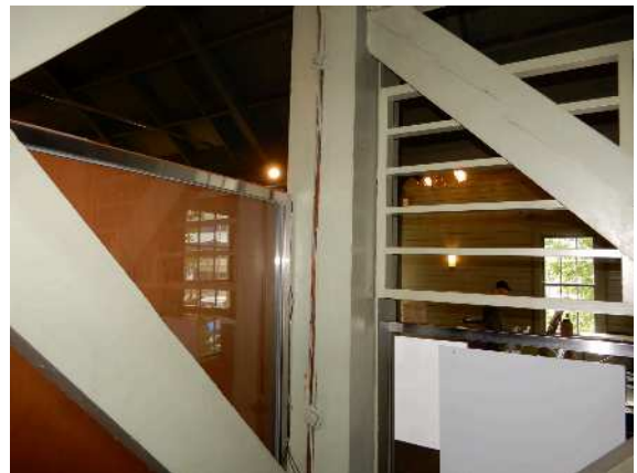
調査写真12. 時計塔 柱の割れ
