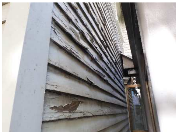
調査写真8. 東階段室 北面外壁の塗装剥離
