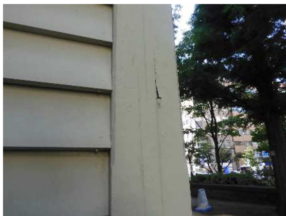
調査写真5. 部分的な塗装剥離
