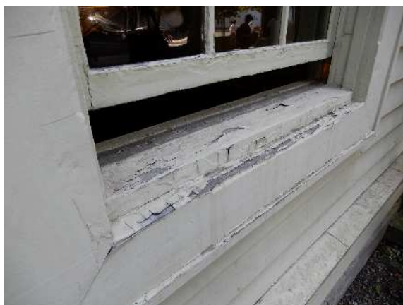
調査写真3. 窓下枠の水切り部分の傷み
