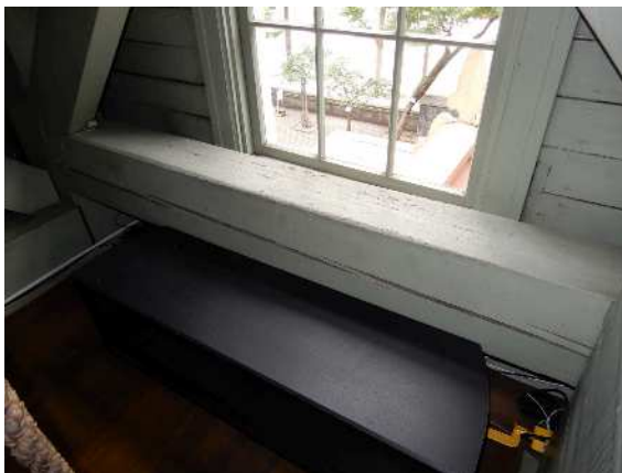
調査写真13. 時計塔 横架材の割れ
