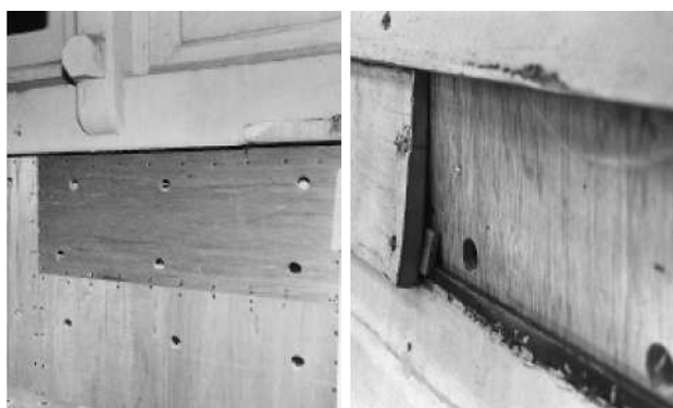
写真22 外壁内結露対策 左:構造用合板に開けた湿気排出穴、右:羽重ね部分に噛ませた3mm合板 (出典:H10年保存修理工事報告書)
