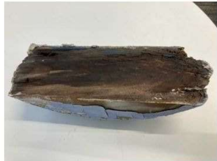
棟飾り破損状況③
