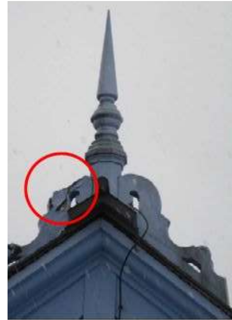
棟飾り破損状況①
