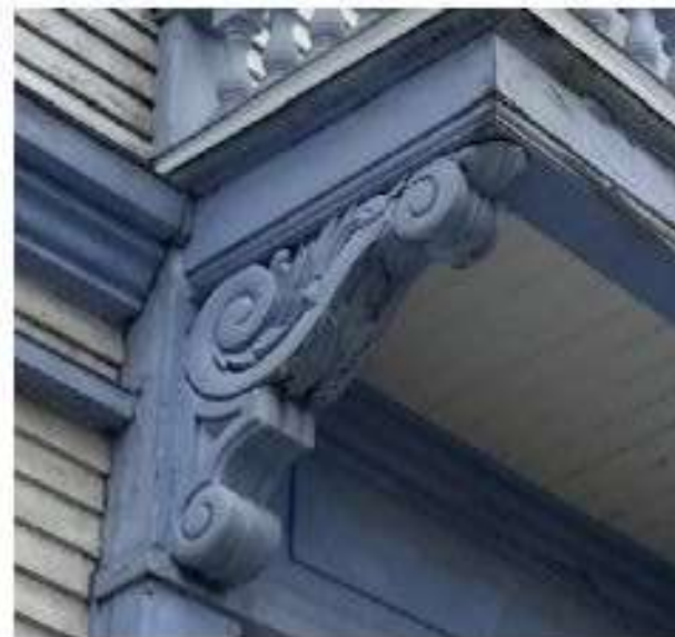
持ち送り・幕板破損前
