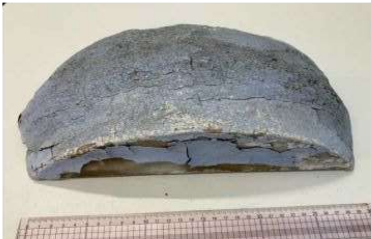
棟飾り破損状況②
