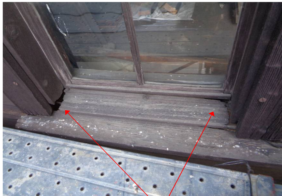
木の腐食により隙間がある
