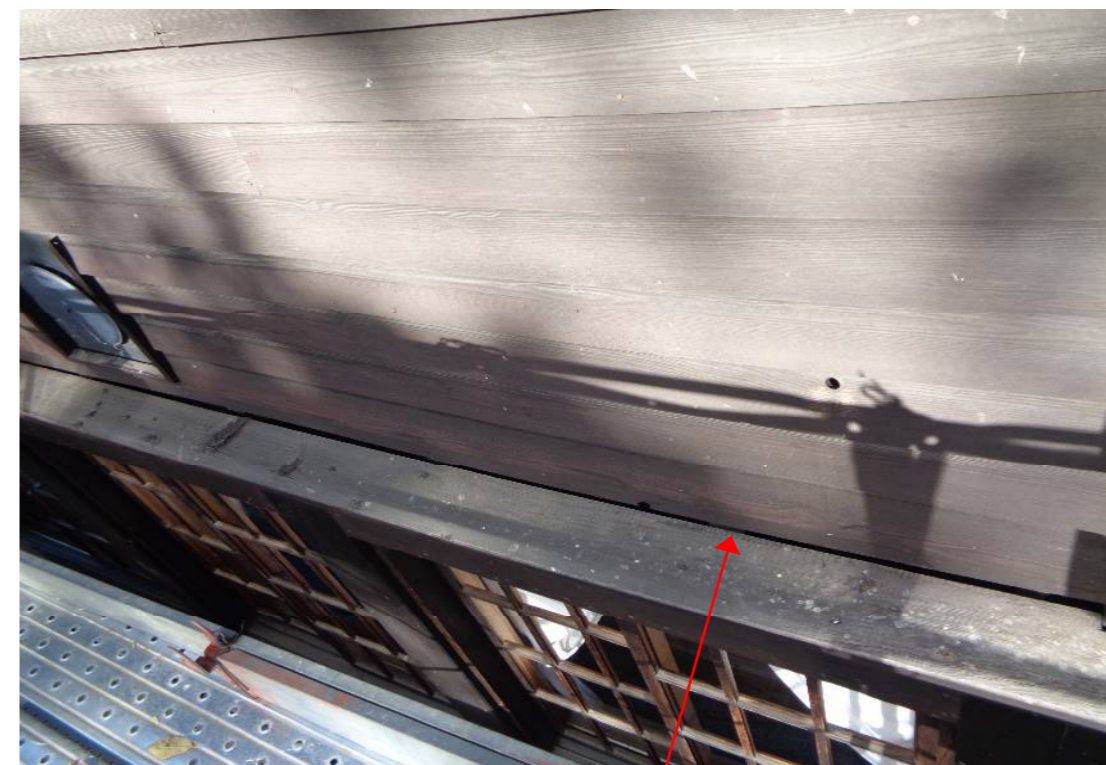
建物の歪みにより外壁との隙間がある
