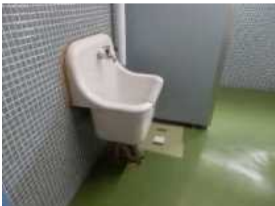
※床の汚れ・損傷
