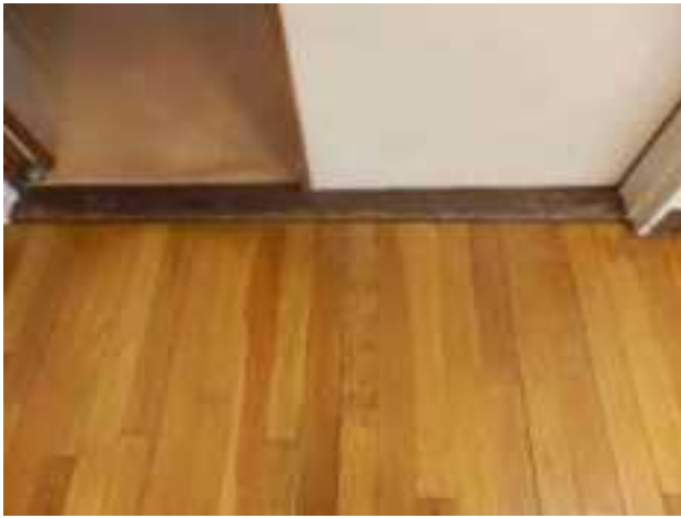
※廊下出口の床材損傷
