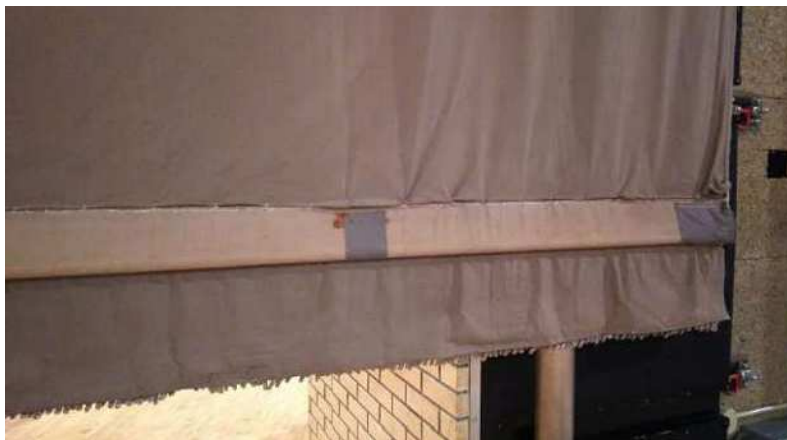
劣化部①(下端パイプ袋)
