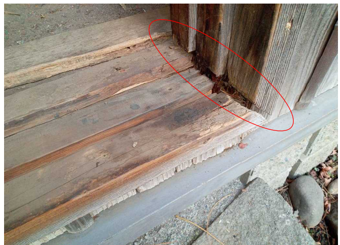
敷居腐食状況
