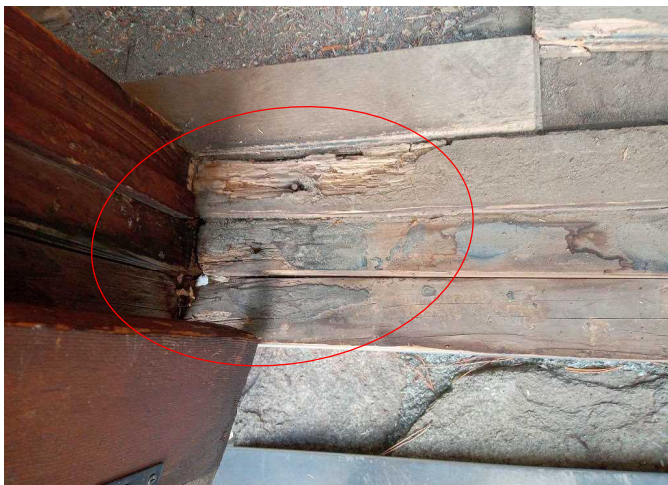
敷居腐食状況
