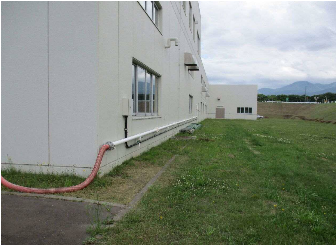
第3山口処理場 接地埋設場所（参考写真）
