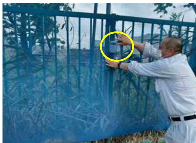
遠隔メーター設置場所
