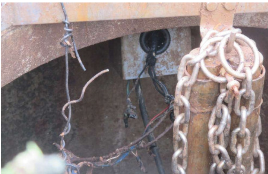
浸出水集水設備 No.3
