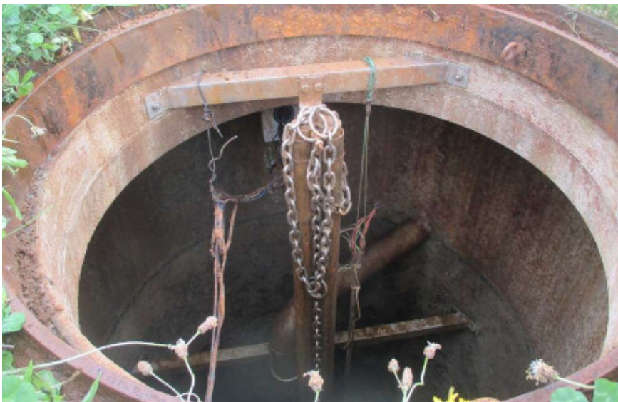
浸出水集水設備 No.3
