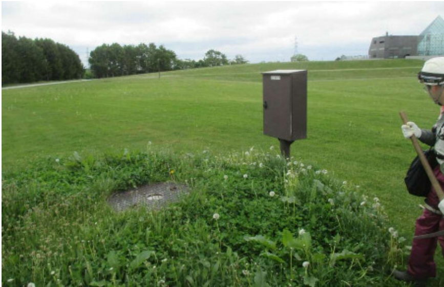
浸出水集水設備 No.3
