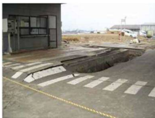
トラックスケール周辺の沈下 （石巻広域クリーンセンター） 宮城県石巻市
