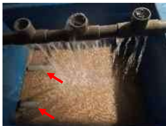
上から見たろ過槽の内部 ろ過後の水の取水口となる穴開きの塩ビ管 2 本（赤矢印）がろ材の上方に露出している
