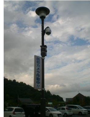
駐車場の防犯カメラ
