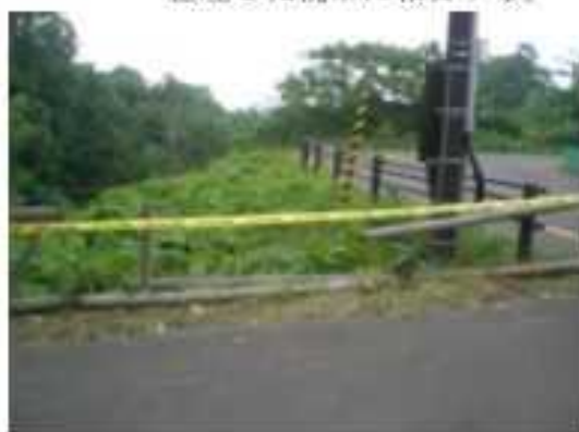
木柵破損状況及び立入禁止処置
