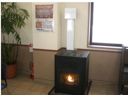
管理事務棟に設置したペレットストーブ
