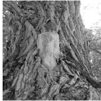
【西側】上部剪定痕からの腐朽
