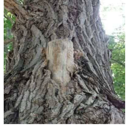
【西側】上部剪定痕からの腐朽
