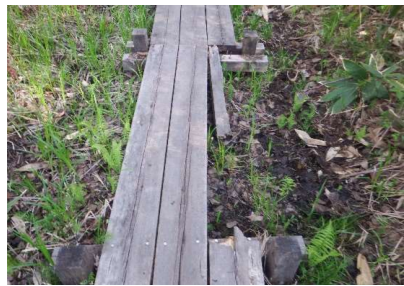
破損した木道(自然歩道)
