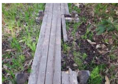
破損した木道(自然歩道)
