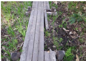
破損した木道(自然歩道)
