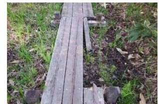
破損した木道（自然歩道）
