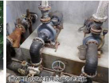
西9丁目の遊水路用設備の老朽化
