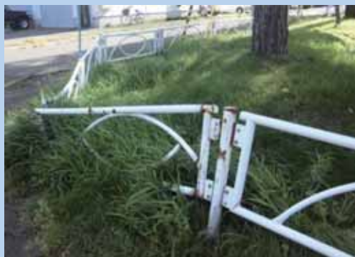
【外柵フェンス（老朽化・破損）】
