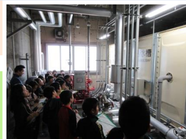
普段は入ることのない小学校のポンプ室などの設備を探検
