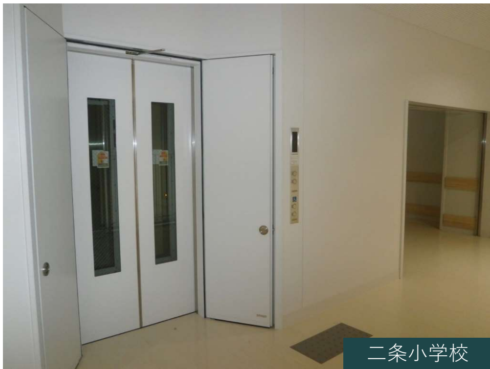
エレベーター
