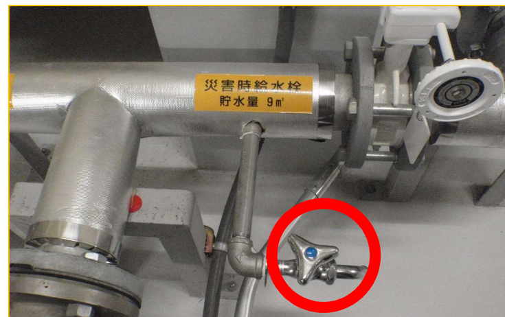
受水槽の非常用水栓
