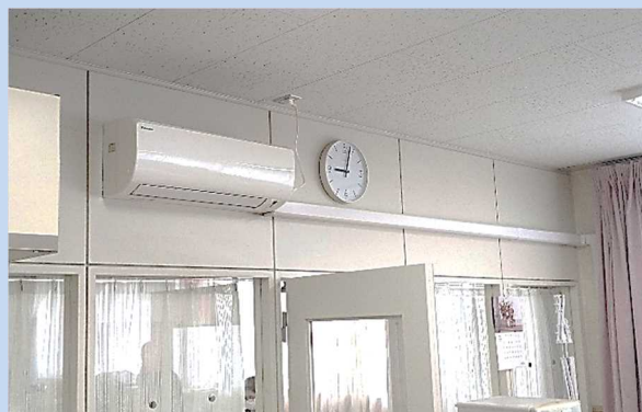
冷房設備（壁掛けエアコン）
