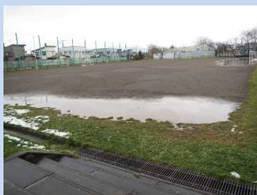
大きな水溜まりが発生
