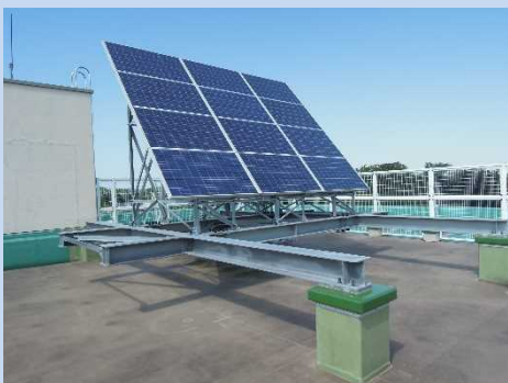
太陽光発電設備
