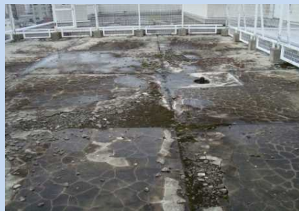
屋上保護コンクリートの劣化
