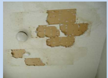
漏水による天井材の劣化
