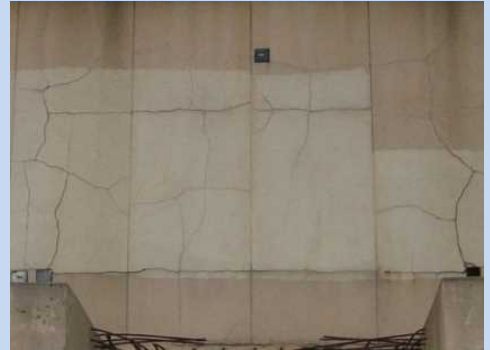
外壁のひび割れ、剥離
