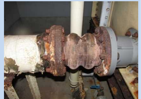
給水設備の老朽化
