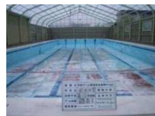
築16年 プール槽の塗装の劣化
