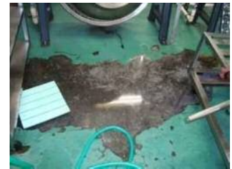
築 34 年 塗床の剥離
